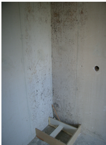
Foto: Misfarvning på væg som følge af skimmelvækst
